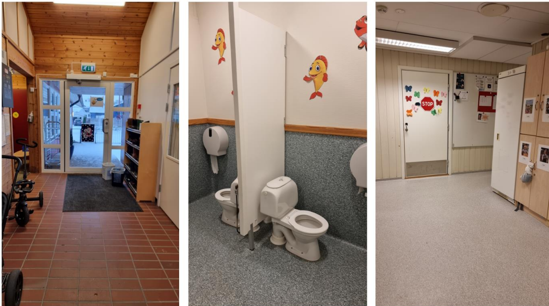
Figur 16 Bildene viser inngangsparti med gang som er gjennomgående i bygningen. For å gå mellom avdelingene, må skitten sone krysses. Toaletter i stellerom har ikke avlukke. Toalettene er eksponert mot annen aktivitet i rommet. Det siste bildet viser gang mellom avdelingene. Gangen er benyttet til fingarderober. Plassering av tørkeskap i området medfører at tøy som tilhører skitten sone trekkes inn i ren sone. Bildet fra gangen viser også at det er lukket struktur, uten innsyn i tilstøtende rom.
